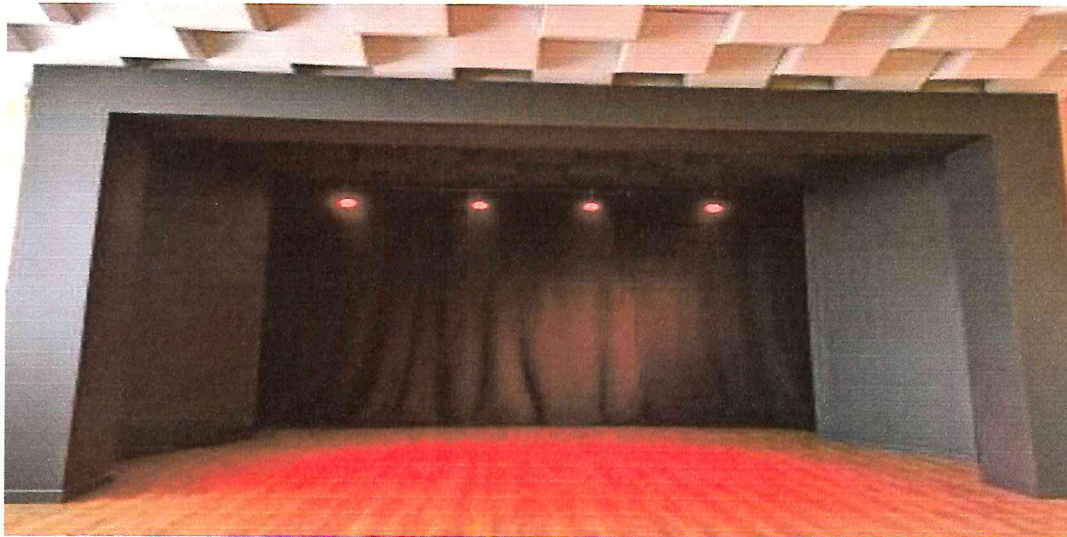
Scena w sali widowiskowej w GCK po zainstalowaniu nowego oświetlenia w 2021r.
